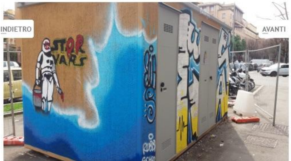
Cabina Enel via Gramsci - dopo Image 2 of 7
